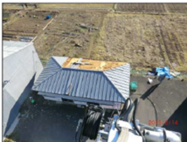
④ 屋根がめくれた事務所 【西から撮影】
