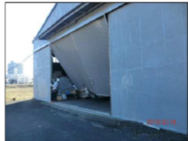
③ 扉の一部が損壊した倉庫 【北西から撮影】
