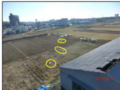
② 屋根の一部が飛散した倉庫及び飛散物 ※楕円は特に大きな飛散物(屋根の破片) 【北西から撮影】
