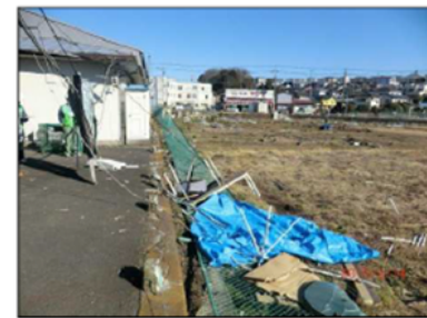
⑤ 倒壊したフェンス(長さ約70m) 【南から撮影】
